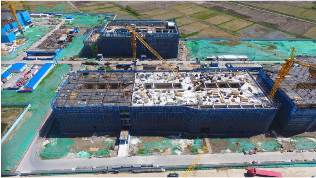
主体结构封顶，首层、二层模板拆除完成，二次结构样板间 施工
