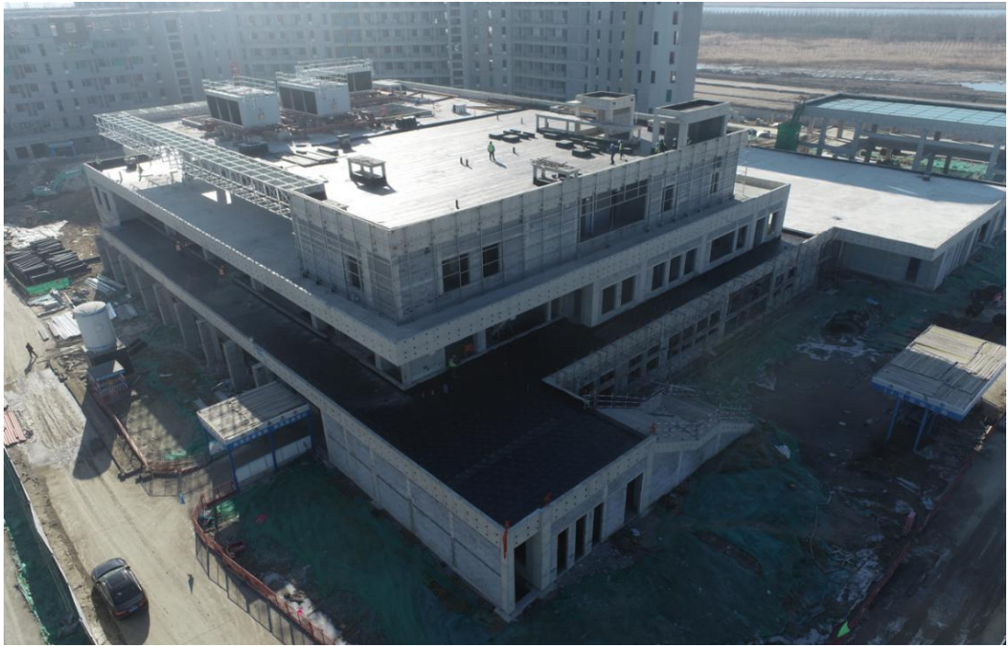
学生食堂屋面施工完成，全面展开外墙保温施工，室内地面贴砖及窗框安装正进行
