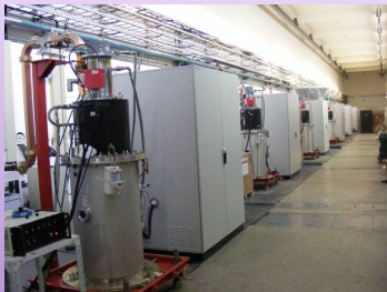
直线加速器速调管长廊
