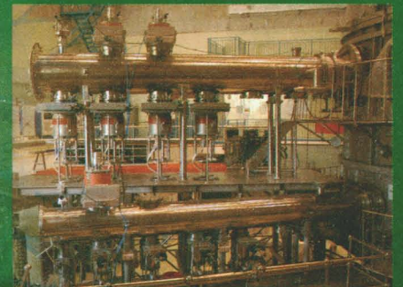
真空抽气系统
